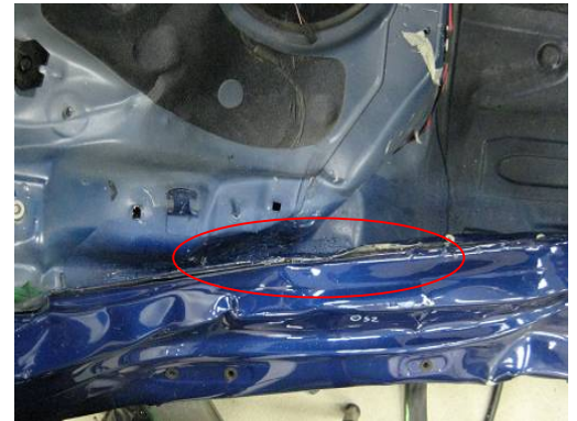
Bild 25: Abriss der WPS-Naht 2. Versuch
